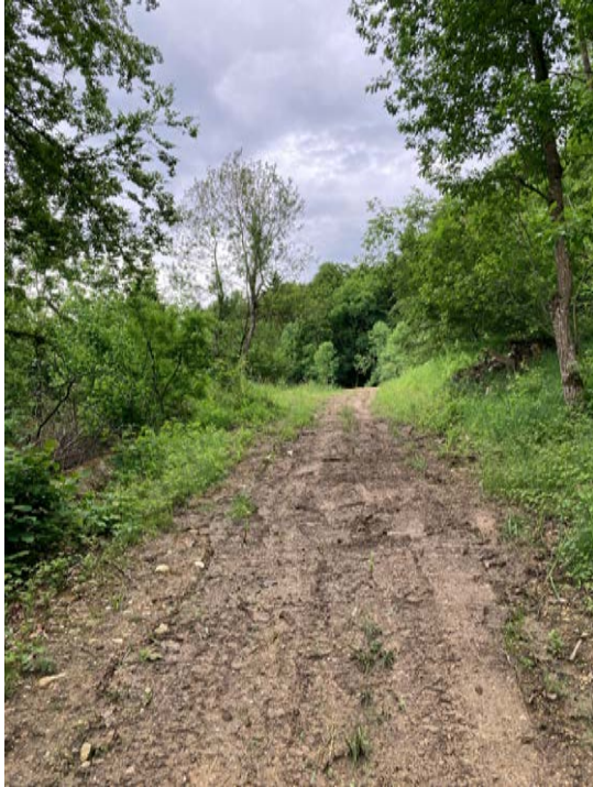
Die tiefen Fahrspuren der Baumaschinen in der Zufahrtspiste zum Weiher hat der Unternehmer am Schluss der Arbeiten ausplanert, damit das Mähen dieser Fläche einfacher durchgeführt werden kann.
